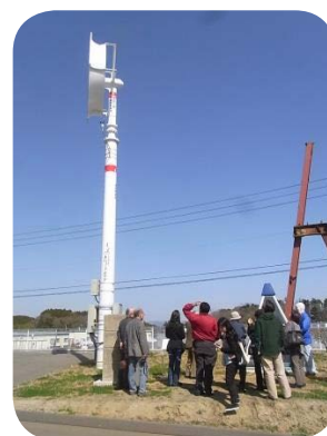
高橋徳治商店に設置している小風力発電
