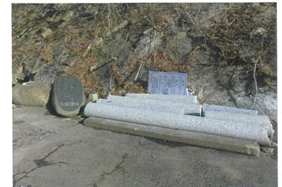
倒壊した鳥居の支柱
