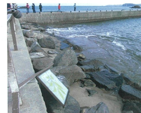
津波の爪痕が残る大森崎(上部は、荒島に繋がる防波堤)
