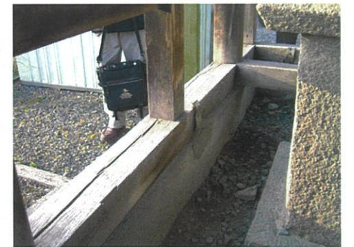
固定金具のせん断変形による曲り
