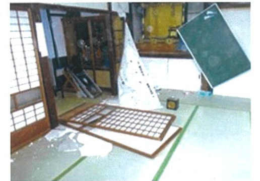
公会堂内の被災状況
