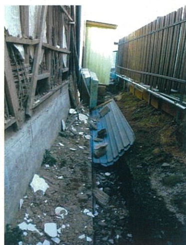
地震で崩壊した東側土壁
