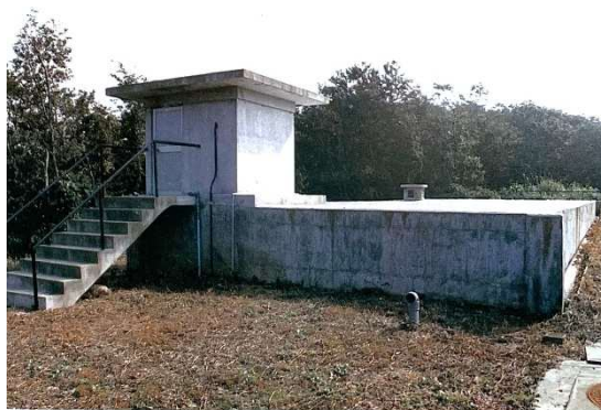
●石浜配水池 410m 3
